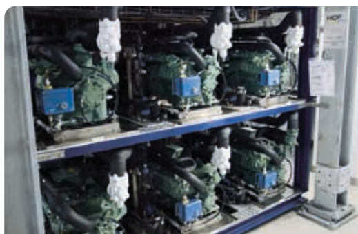
Structure modulaire de six compresseurs
